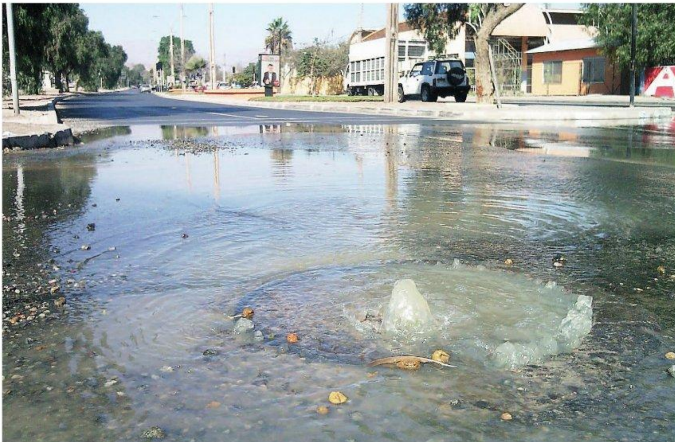
Un lector nos envió una foto acerca del colapso de una cámara de alcantarillado, ubicada en avenida Circunvalación con Maipú. Según nuestro lector, no es primera vez que se revienta esta misma cámara. La foto fue captada el sábado recién pasado cerca del mediodía y los vecinos se quejaron por el olor nauseabundo que se percibía.
